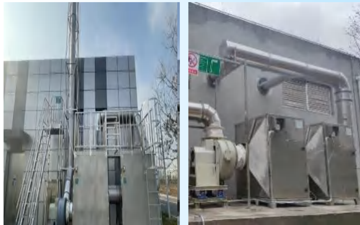
废气处理设施
