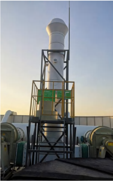
废气处理设施
